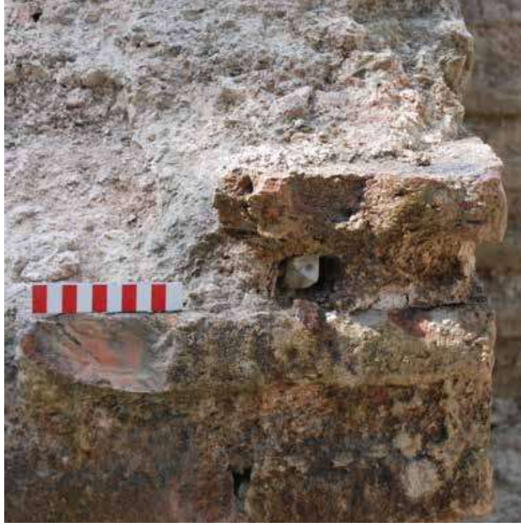
Fig. 4: Duvar kaplaması olarak kullanılan mermer levhann taşıyıcı metal kanca (Fotoğraf: A. Enez) Fig. 4: Preserved iron holder fragments of marble cover of the walls (Photograph: A. Enez)
