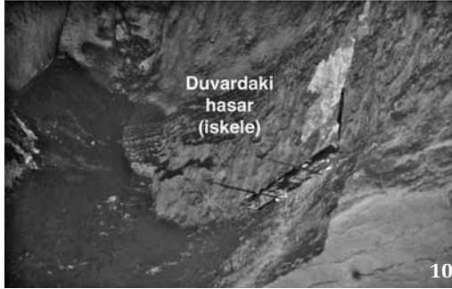
Res. 10-12: Tahribatı detaylandırmak üzere bölümlediğimiz haritaya göre, 2. bölümdeki tahribat.
